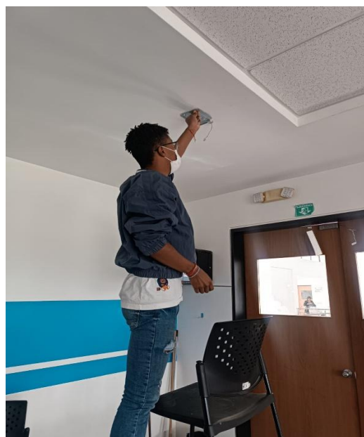
Figura 1. Paso de Cable en las Instalaciones
